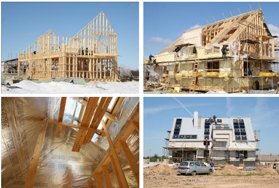
Рис. 3. Фото со строительства объекта (Возведение каркаса, утепление здания, устройство пароизоляции, установка мансардных окон и солнечных коллекторов)
